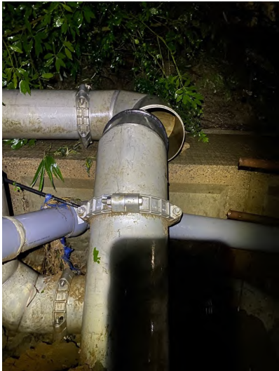
＜輪島市河井町＞ 仮設管抜け（送水管）
