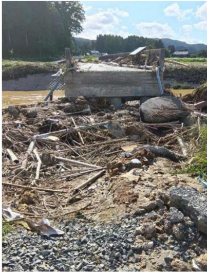
< 珠洲市若山町 > 添架管破損
