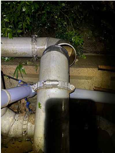
< 輪島市河井町 > 仮設管抜け（送水管）
