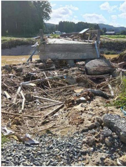
< 珠洲市若山町 > 添架管破損
