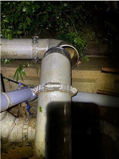
< 輪島市河井町 > 仮設管抜け（送水管）
