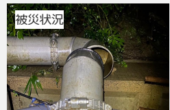
被災状況 復旧状況
