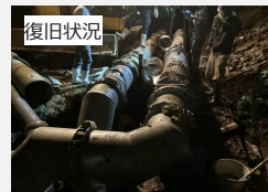
＜輪島市河井町＞仮設管抜け
