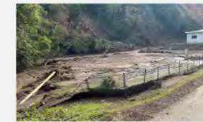
＜珠洲市大谷町＞ 大谷浄水場沈砂池への土砂流入
