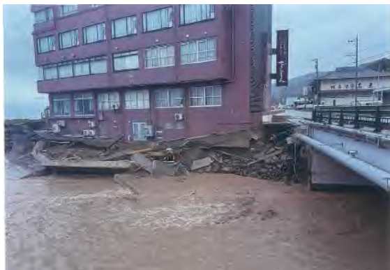
海岸護岸の一部が被災(応急復旧を準備中)
