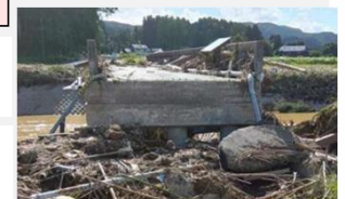
＜珠洲市若山町＞仮設管破損
