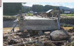
＜珠洲市若山町＞水道管破損
