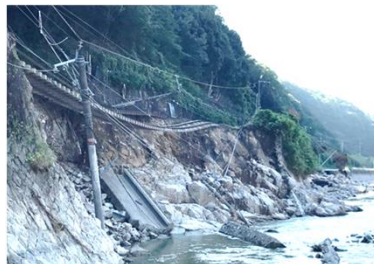
JR山陽線 盛土崩壊・土砂流入 (平成30年台風7号による被害)
