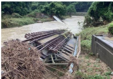
JR美祢線 橋りょう倒壊 (令和5年梅雨前線による被害)
