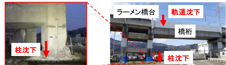
令和4年3月の地震による被害
