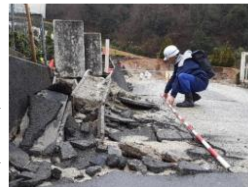
岩屋浄水場の被災（七尾市）
