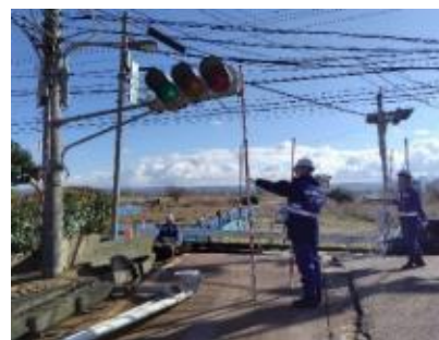
道路の被災状況調査 (石川県内灘町)
