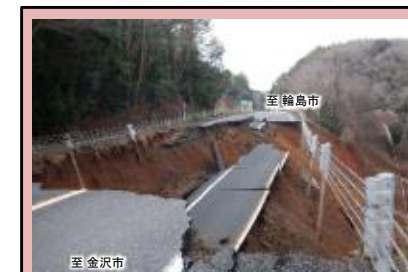
写真⑤ 能越自動車道の道路崩壊
