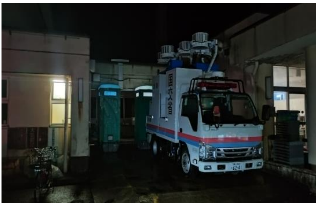
旧本小学校への電源供給
