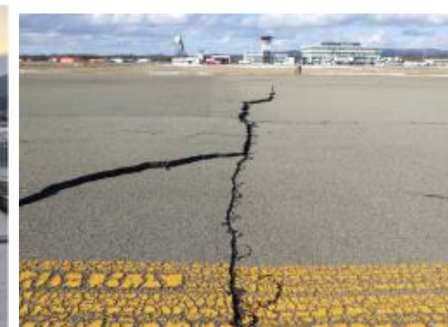
能登空港の被災（穴水町）
