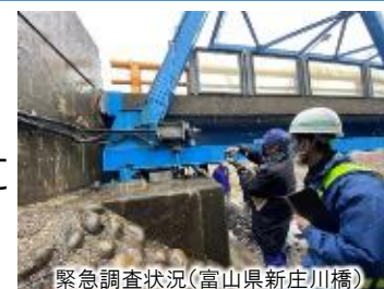
緊急調査状況(富山県新庄川橋)
