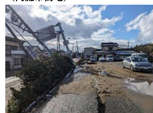
液状化被害 （内灘市街地）
