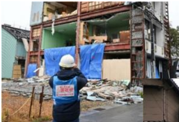
建築物の損壊状況（七尾市）
