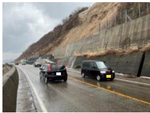
<通行止め解除後の状況>
