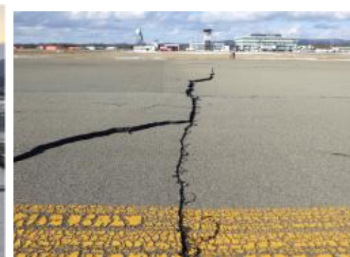
能登空港の被災（穴水町）
