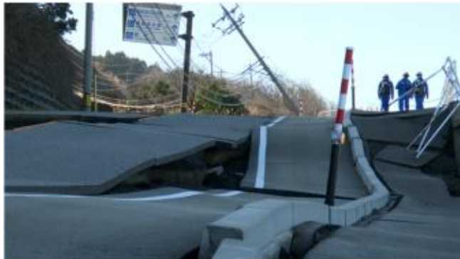
国道249号道の駅千枚田付近（輪島市）
