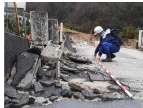
岩屋浄水場の被災（七尾市）
