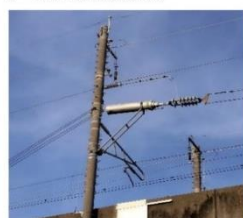
新幹線電車線（架線）設備
