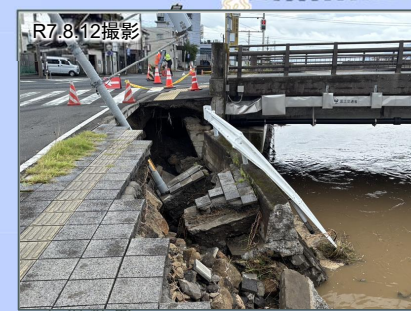
▲②国道10号（鹿児島県始良市）橋台背面の洗掘
