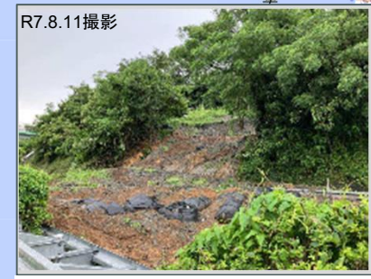
▲①E3九州道（松橋IC～八代IC）土砂流入
