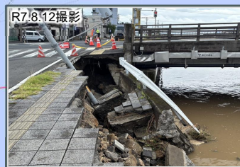
▲国道10号（鹿児島県始良市）橋台背面の洗掘
