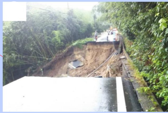
▲国道249号(石川県七尾市)道路崩落
