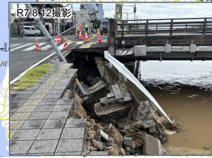
▲①国道10号（鹿児島県始良市）橋台背面の洗掘 いちき串木野
