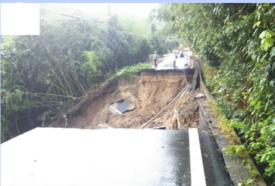
▲国道249号(石川県七尾市)道路崩落
