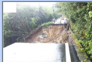
▲国道249号（石川県七尾市）道路崩落 ※損壊箇所へ車両3台の転落があり、病院へ搬送されましたが（うち2名軽傷、1名重傷（骨折）、全員命に別状はなく意識あり。
