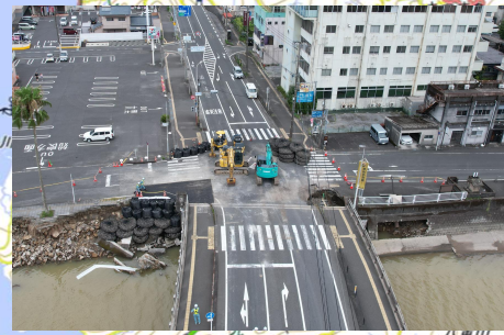
▲①国道10号（鹿児島県始良市）橋台背面の洗掘
