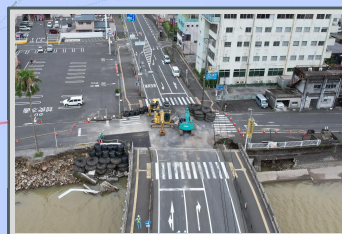
▲国道10号(鹿児島県姶良市)橋台背面の洗掘
