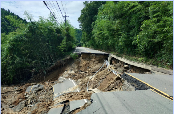
▲国道249号(石川県七尾市)道路崩落
