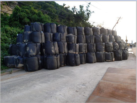
▲国道249号(石川県珠洲市)道路崩落
