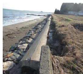
②上戸地区：護岸損壊状況
