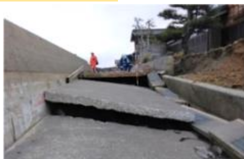
護岸・水叩き損傷
