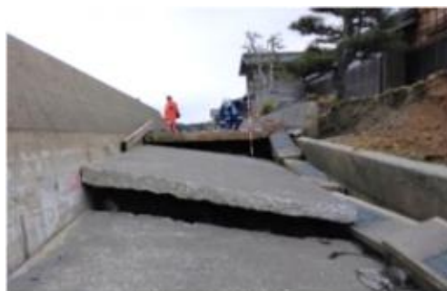
護岸・水叩き損傷
