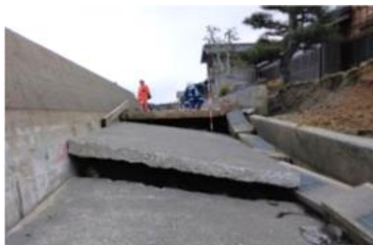
護岸・水叩き損傷
