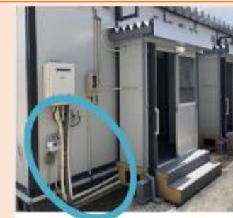
保温材が巻かれた 仮設住宅の配管
