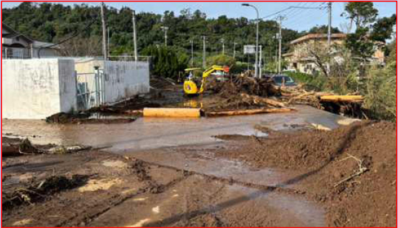
東京都道(八丈町内)の被災状況
