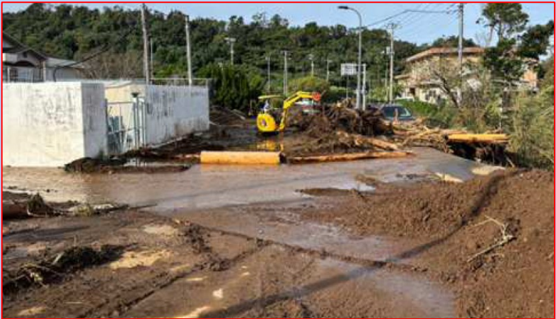
東京都道(八丈町内)の被災状況
