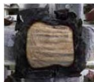
燃焼後の太い柱
