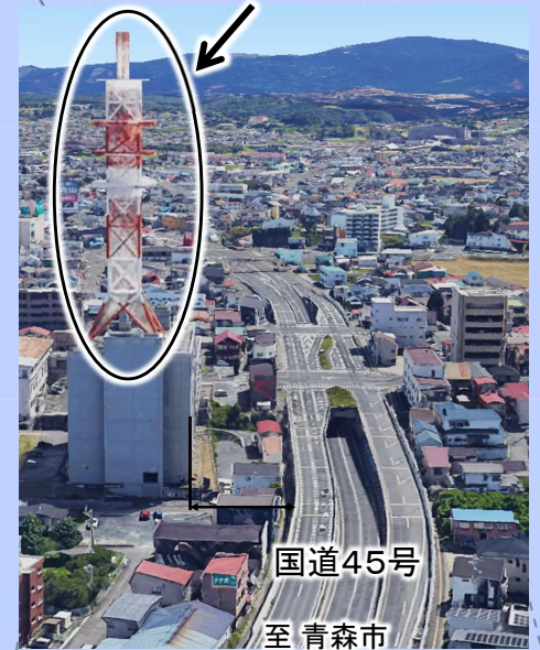
損傷が確認された沿道建築物
