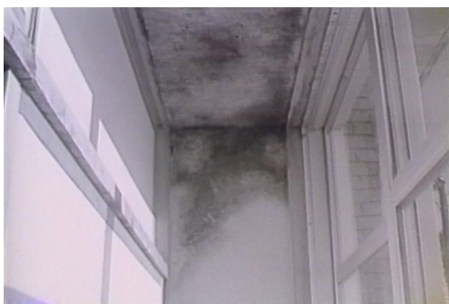
写真 2.1.2 すがもれによる被害
