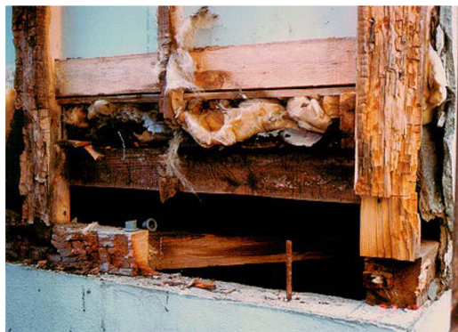
写真 3.2.3 内部結露による躯体の腐朽
