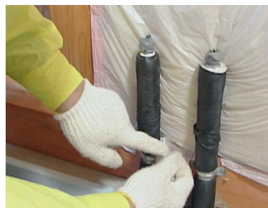
写真 5.1.1 配管まわりの防湿フィルム
