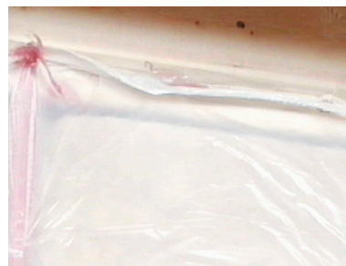
図 5.3.10 防湿フィルムの施工の悪い例 - 2
