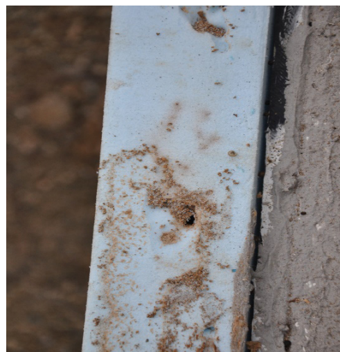
写真 2.2.11 断熱材の被害
