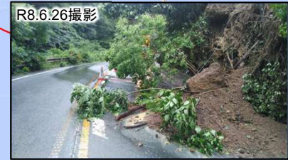
▲国道9号(京都府京都市～京都府亀岡市)土砂流入
