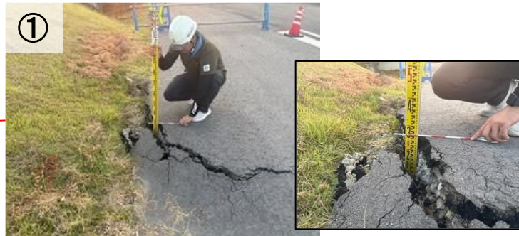
緑川水系緑川(みどりかわ)、加勢川(かせがわ)、 御船川(みふねがわ)、浜戸川(はまどがわ) 天端クラック等 計40箇所 ※詳細調査中
