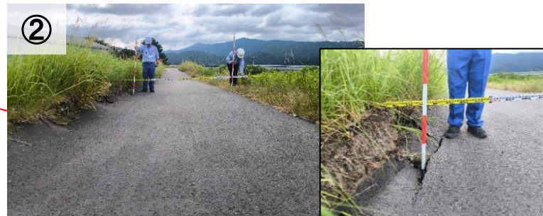
球磨川水系球磨川(くまがわ)、前川(まえがわ) 堤防沈下、天端クラック等 計14箇所 ※詳細調査中
