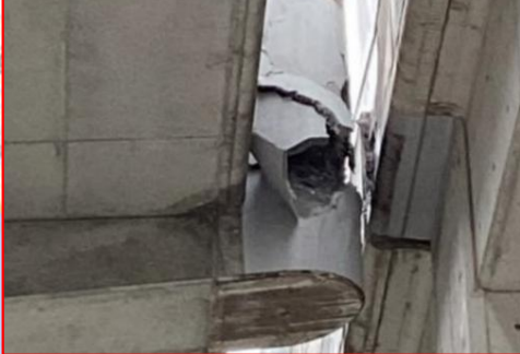
①上熊本～熊本間 電柱基礎の損傷
