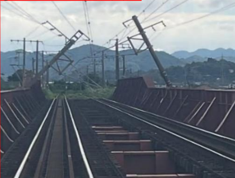
③小川～有佐間 電柱損傷
