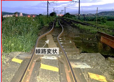
②松橋～小川間 線路変状
