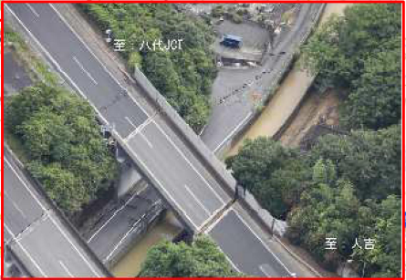
通行止め箇所(片野川橋 橋梁損傷) E3九州自動車道(八代JCT~人吉IC)
