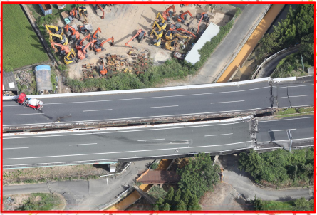
通行止め箇所(川田橋 橋梁損傷) E3九州自動車道(宇城水川SIC~八代IC)
