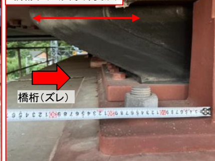
橋桁ずれ(支承部変形)
