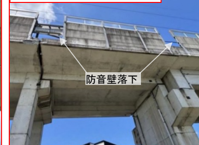
④熊本～新八代間 防音壁落下
