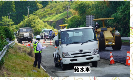
熊本県 《緊急車両通行区間の通行状況》
