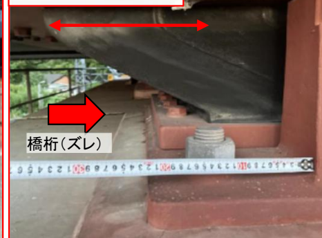
橋桁ずれ(支承部変形)
