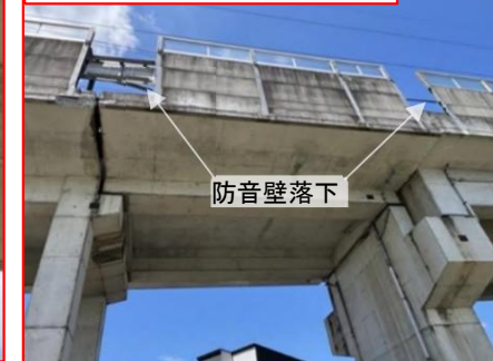
④熊本～新八代間 防音壁落下
