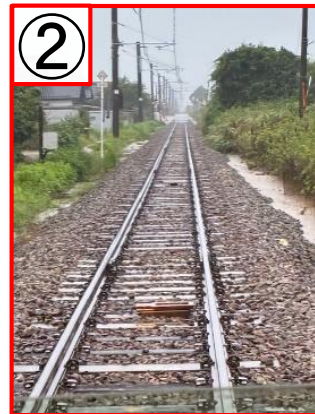
② 金丸～能登部間 線路冠水
