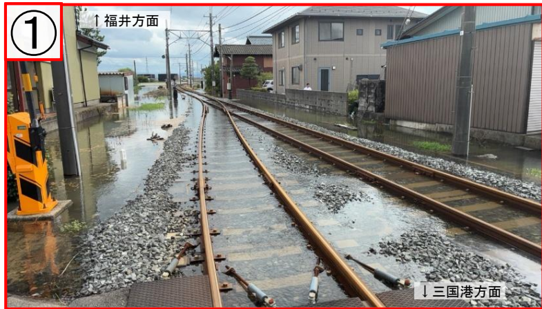
西長田ゆりの里駅 駅構内浸水
