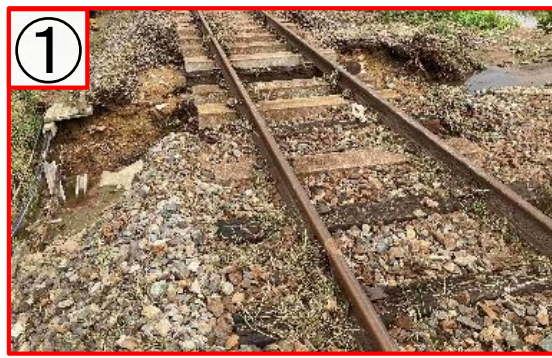
① 千路～金丸間 盛土・道床流出
