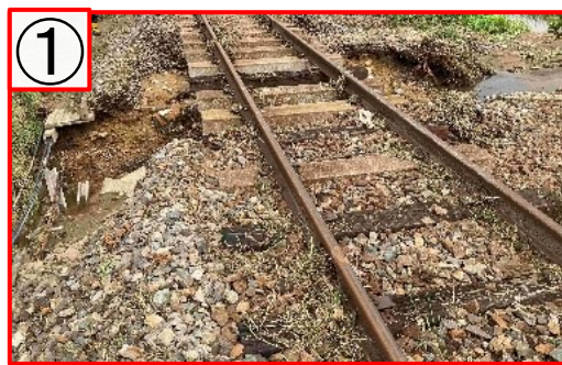
千路～金丸間 盛土・道床流出
