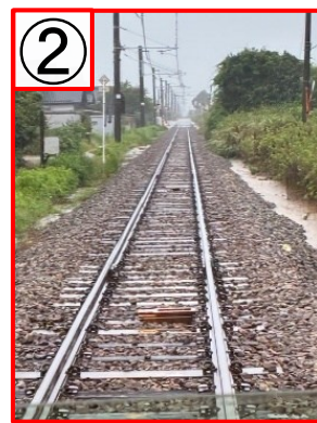
金丸～能登部間 線路冠水
