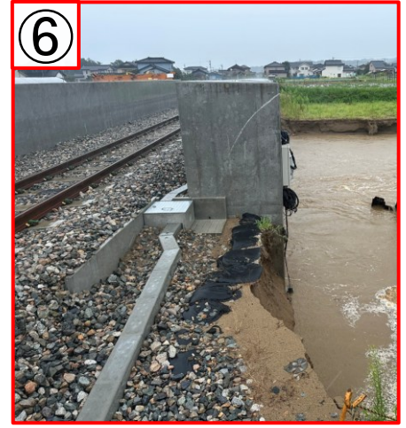
島尾～氷見間 河岸変状
