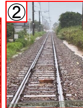
② 金丸～能登部間 線路冠水
