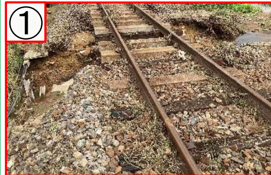
① 千路～金丸間 盛土・道床流出
