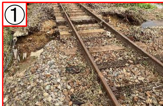
① 千路～金丸間 盛土・道床流出
