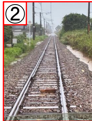
② 金丸～能登部間 線路冠水
