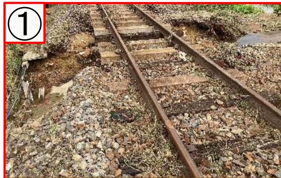
① 千路～金丸間 盛土・道床流出
