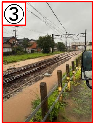
③ 能登部駅構内 線路冠水
