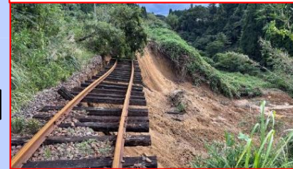
いたぶ つきざき ⑤小湊鉄道・飯給～月崎間 路盤流出
