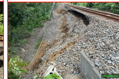
③総武線・八街～日向間 路盤流出
