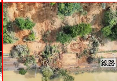
①内房線・姉ヶ崎～長浦間 土砂等流入
