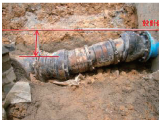
大洞山浄水場着水井流入管被害状況
