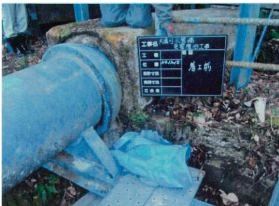
SP φ 600 水管橋印籠継手部の漏水
