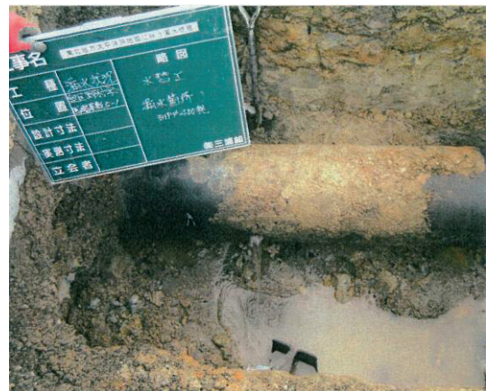
DIP φ 400 直管部の穴から漏水状況
