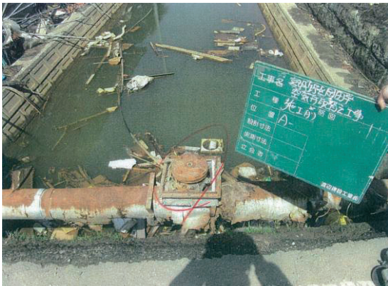
空気弁損傷状況
