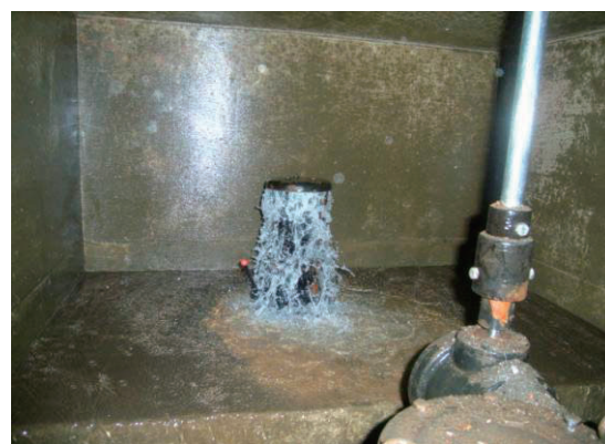
空気弁からの漏水状況
