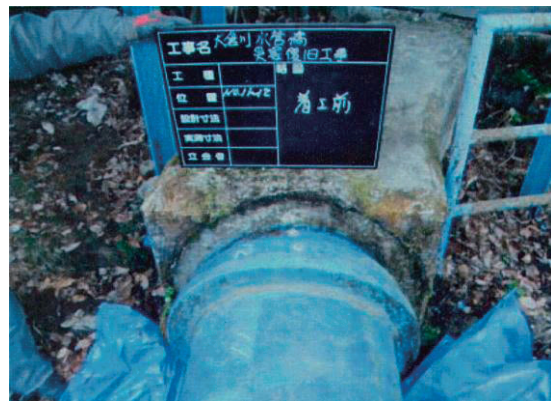
水管橋印籠継手からの漏水
