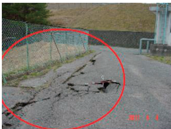
平成 23 年 4 月 6 日 新月浄水場管理用通路被害状況
