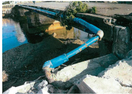
配管離脱落下・空気弁流出状況
