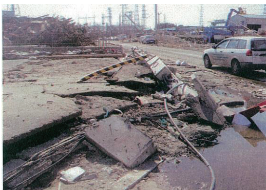
引込柱の倒壊状況
