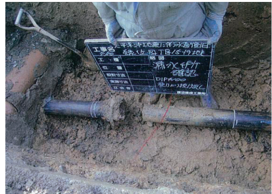
DIP φ 100 継手抜け状況
