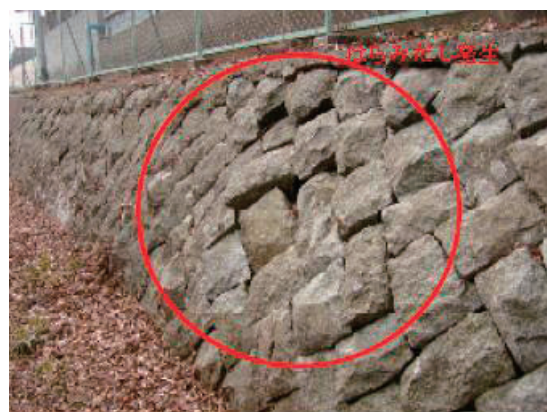
平成 23 年 4 月 8 日 館山浄水場周囲石垣被害状況
