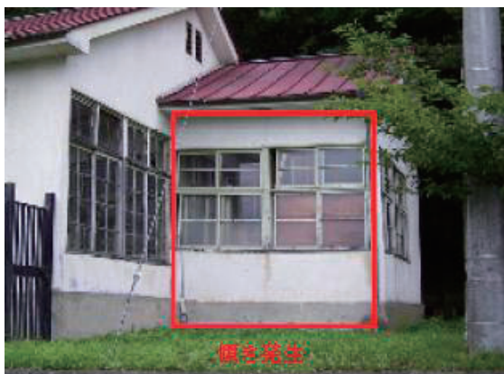
平成 23 年 8 月 3 日 館山ポンプ場建築建屋被害状況
