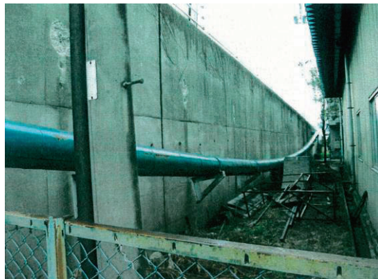
SP φ 200 水管橋擁壁部配管離脱
