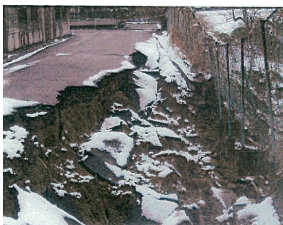
DIP φ 300 地盤崩落による損壊状況
