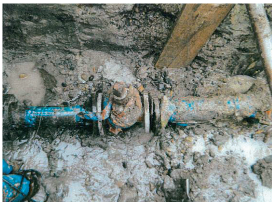
DIP φ 150 継手破損状況
