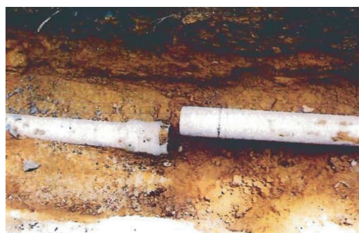
写真 4.6 VP75 (RR 継手) の被害状況 (継手抜け)
