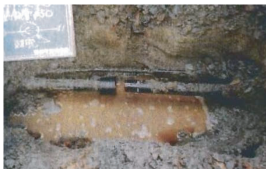
写真 4.5 DIP50 (T形) の被害状況 (継手抜け)
