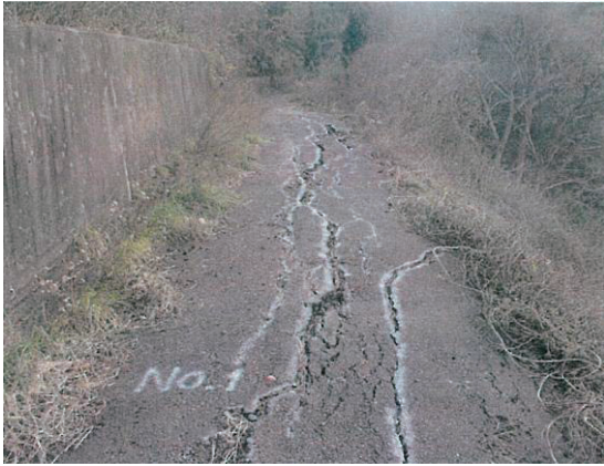
横川配水場管理道路亀裂
