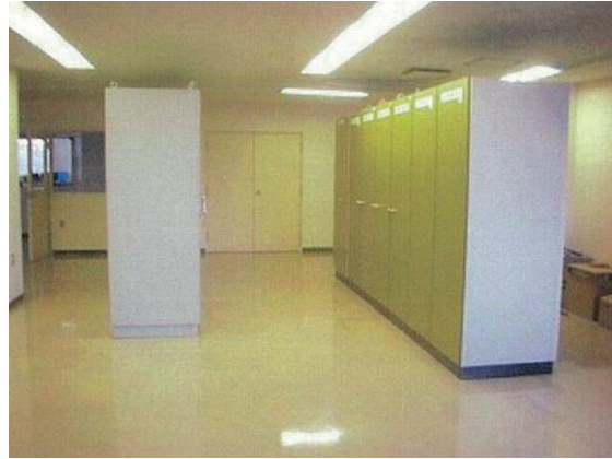
計装設備 (整備後)
