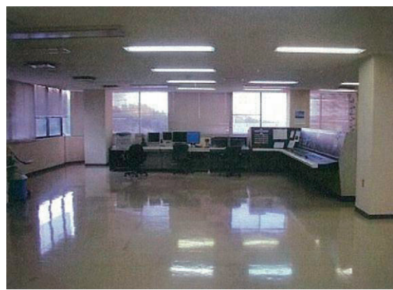
監視制御設備 (整備後)
