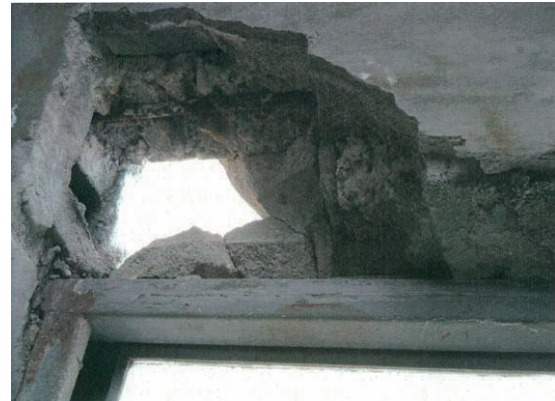
窓付近壁破損
