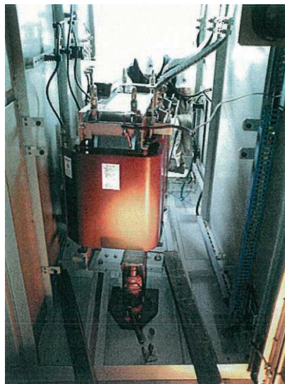
変圧器がレールから脱落した (高圧 300KVA)
