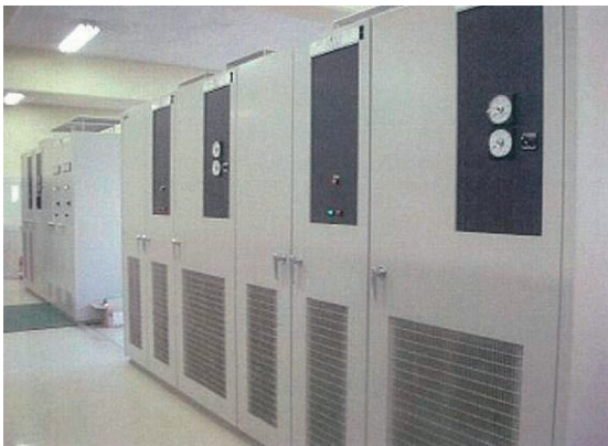
須江山系導水ポンプ用ポンプ盤3台分（整備後）
