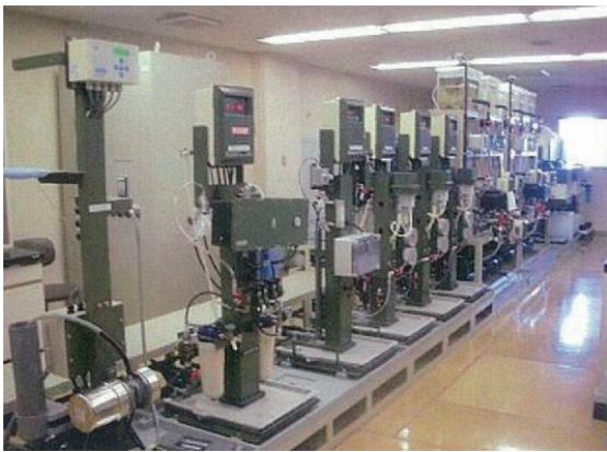
水質計器 (整備後)
