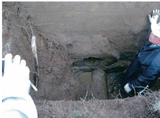
φ250 躯体貫通部での破断
