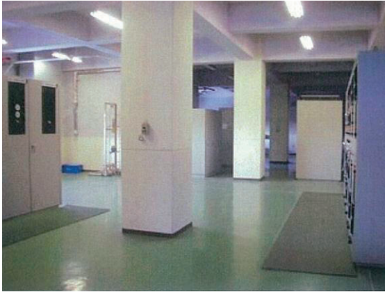
受変電設備 (整備後)
