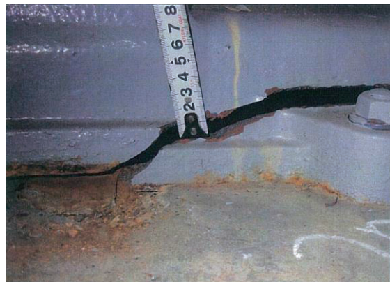
大街道系導水ポンプ2号共通ベースは、地震動及び液状化により破損
