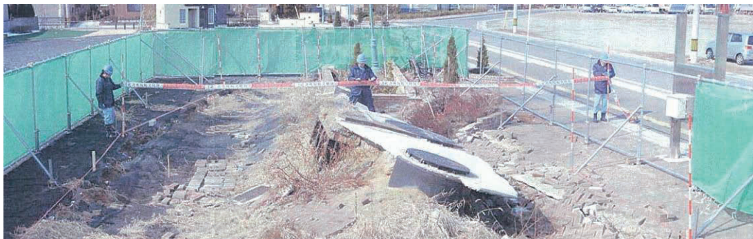
恵み野中央公園飲料水耐震貯水槽（100m 3 ）の被災状況（全景）
