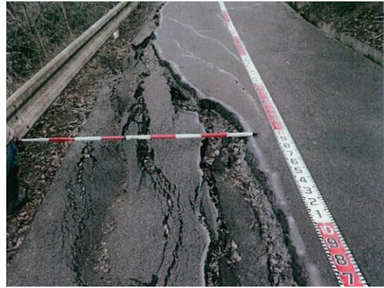
配水場専用道路の路肩崩落
