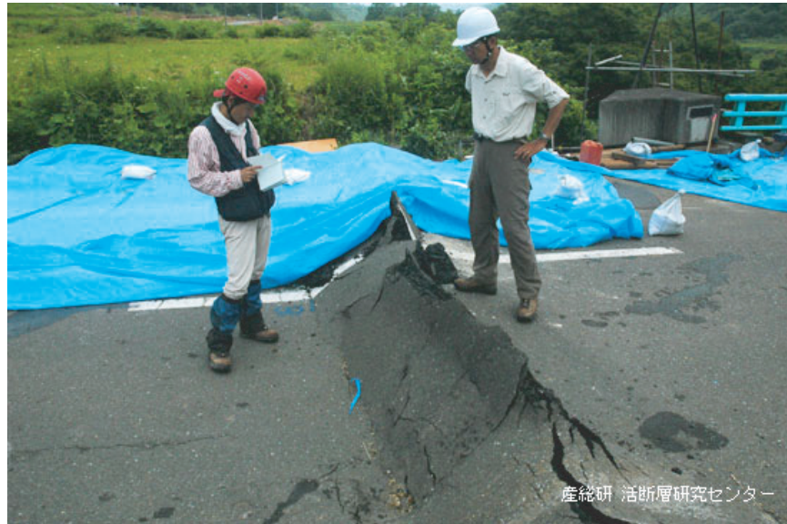
写真 4.4 舗装面の折れ曲がりの様子
