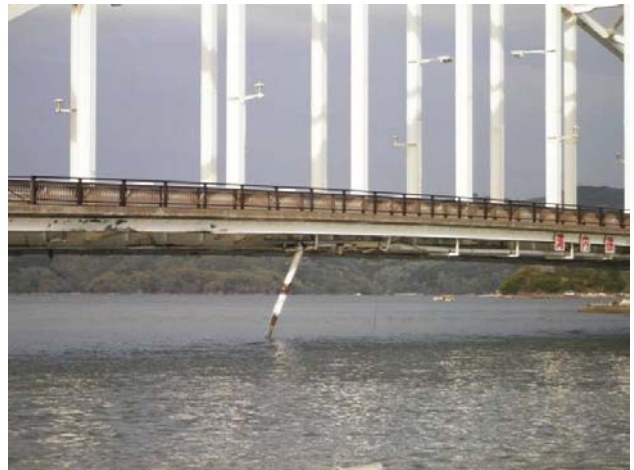
写真 5.3.2 万石橋添架管の被災状況
