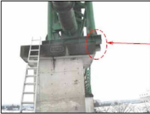
水管橋のずれ
