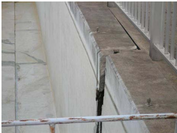
■エキスパンションジョイントの被害
