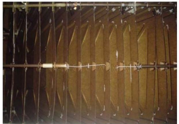
■ 麓山浄水場(沈澱池傾斜板破損)
