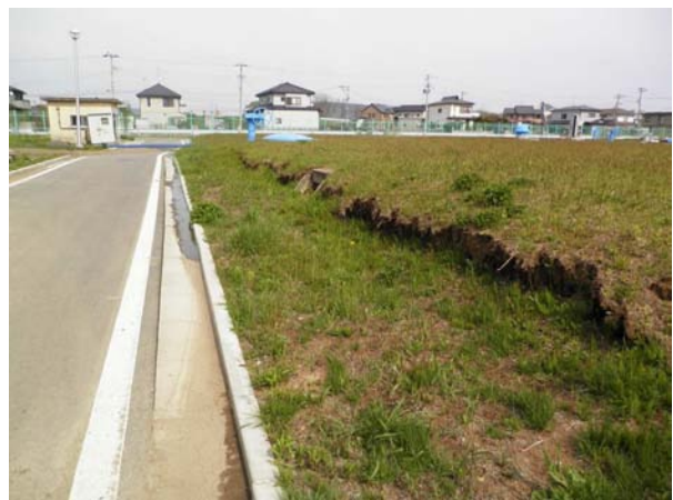
■液状化による沈下（右側は浄水池）
