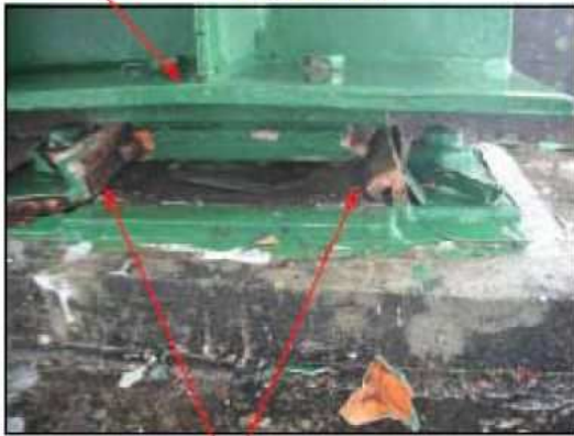
横門橋(支承部)の変形 トラス水管橋
