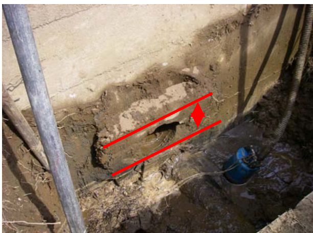
■浄水池越流管の折損状況（地盤沈下による）
