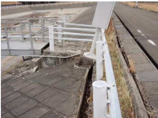
■ 中峰浄水場の被害状況
