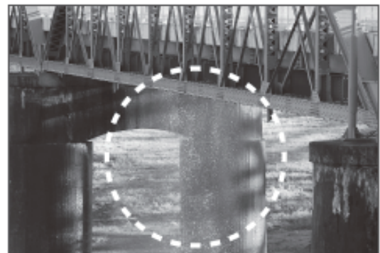
写真 4.133 添架管からの漏水状況
