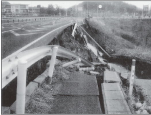
▲国道4号バイパス崩落箇所
