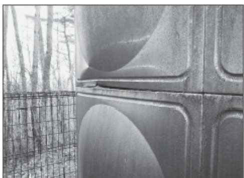
▲絵馬平配水槽の損傷状況
