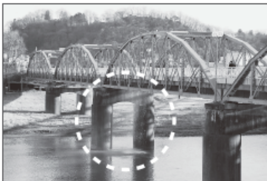
▲松鈴橋に添架された配水管（SP400A）からの漏水状況
