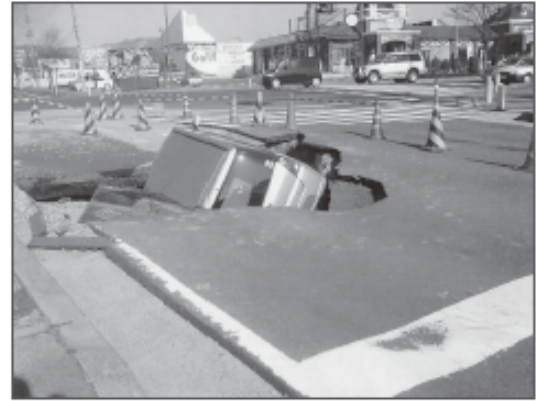
▲野田町地内道路陥没箇所
