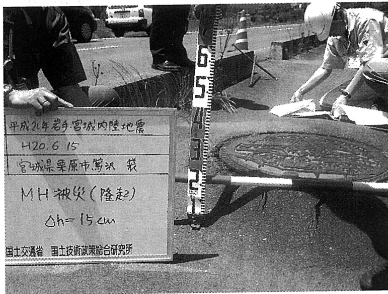
栗原市の鶯沢地区でマンホールが浮上 (写真提供=国土技術政策総合研究所)
