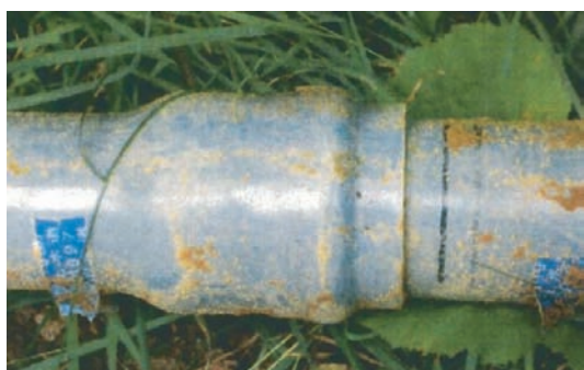
写真 4.7 VP100 (RR 継手) の被害状況 (継手漏水)
