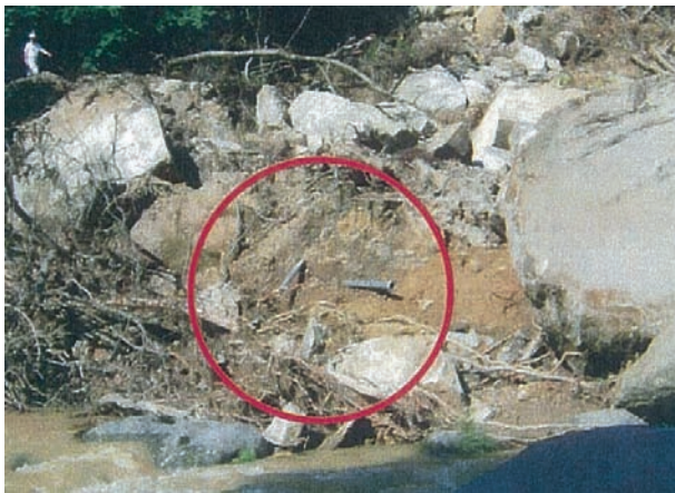
写真 4.12 既設配水管消失 (花山温湯簡易水道 管端が見えている)
