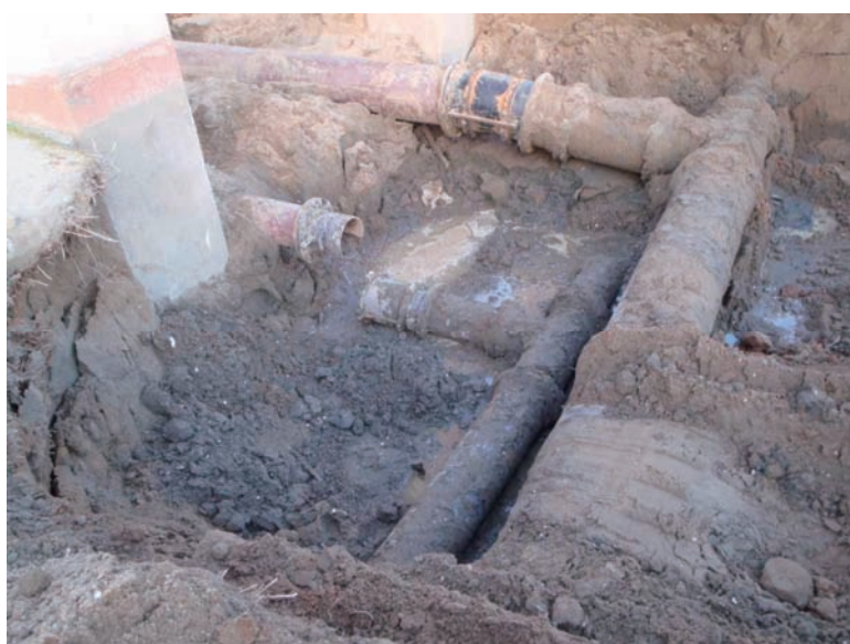
写真 2.8 場内連絡管路の被災例（茨城県企業局鱈川浄水場）
