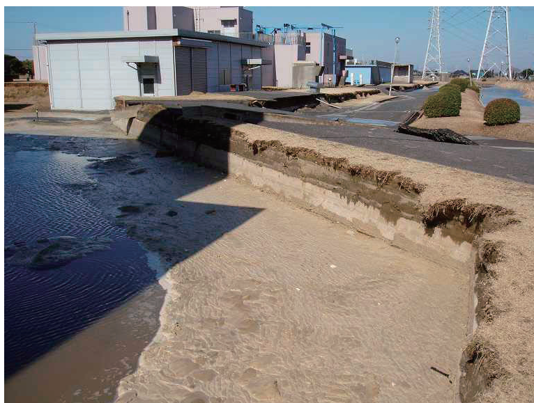
写真 2.7 液状化による被害例（茨城県企業局鱈川浄水場）
